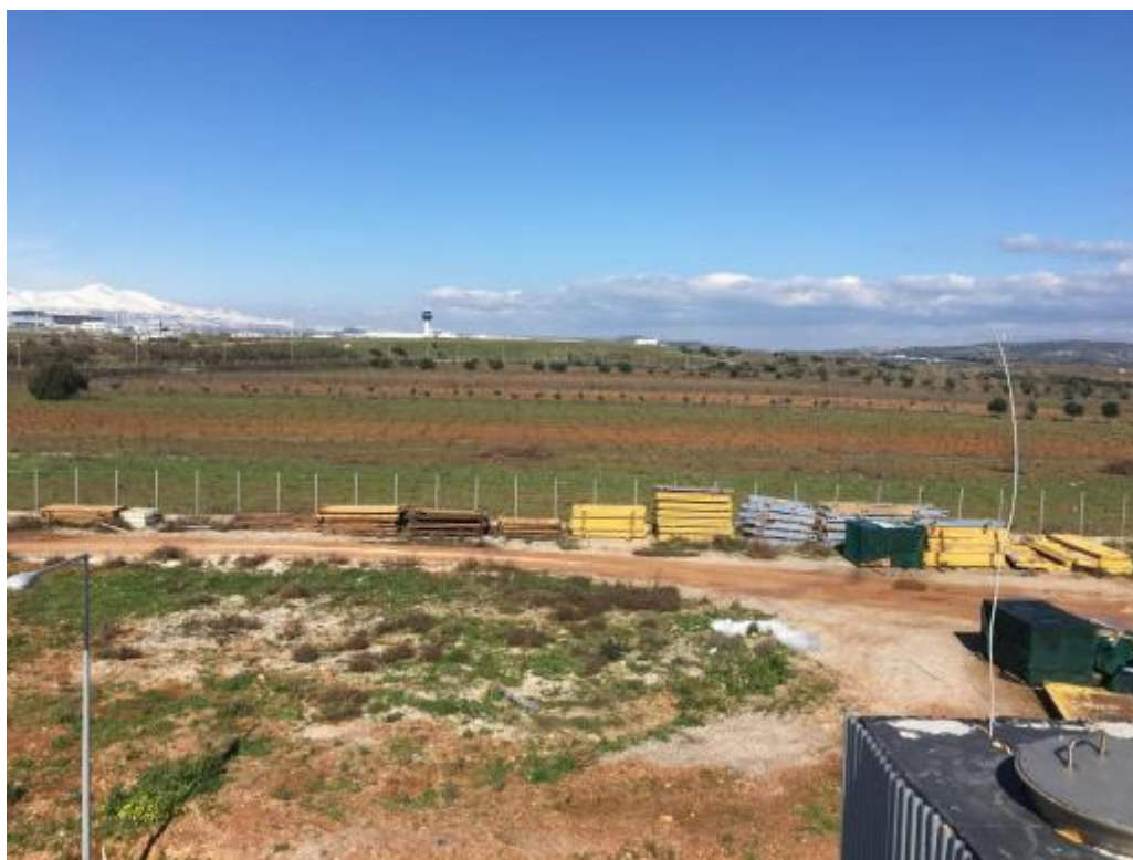
Φωτογραφία 18: Χώρος κατασκευής νέων έργων επέκτασης βορειοανατολικά του γηπέδου ΚΕΛ Κορωπίου – Παιανίας. Θέση χωροθέτησης των νέων μονάδων A4, A5, A6, A7 & A12
