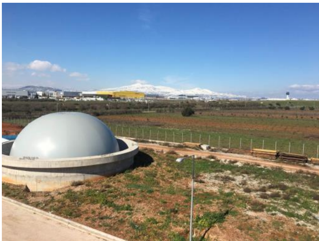
Φωτογραφία 17: Χώρος κατασκευής νέων έργων επέκτασης βορειοανατολικά του γηπέδου ΚΕΛ Κορωπίου – Παιανίας. Θέση χωροθέτησης των νέων μονάδων A4, A5, A6, A7 & A12
