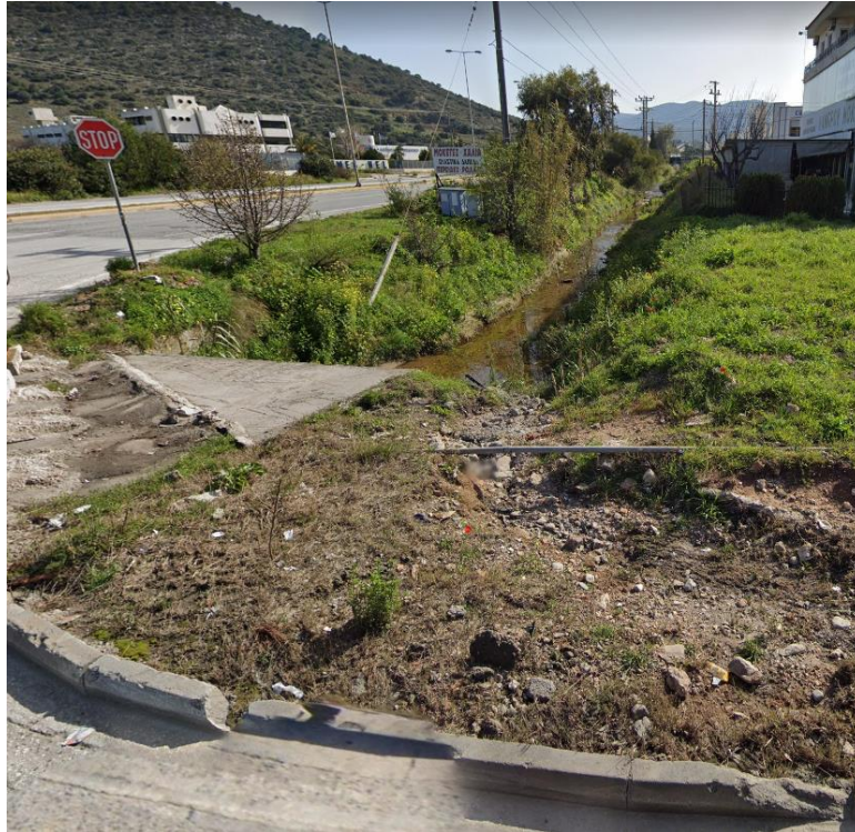
Φωτογραφία 22: Η φυσική κοίτη του ρέματος Κουβαρά κατάντη του τεχνικού διέλευσης στη Λεωφόρο Λαυρίου
