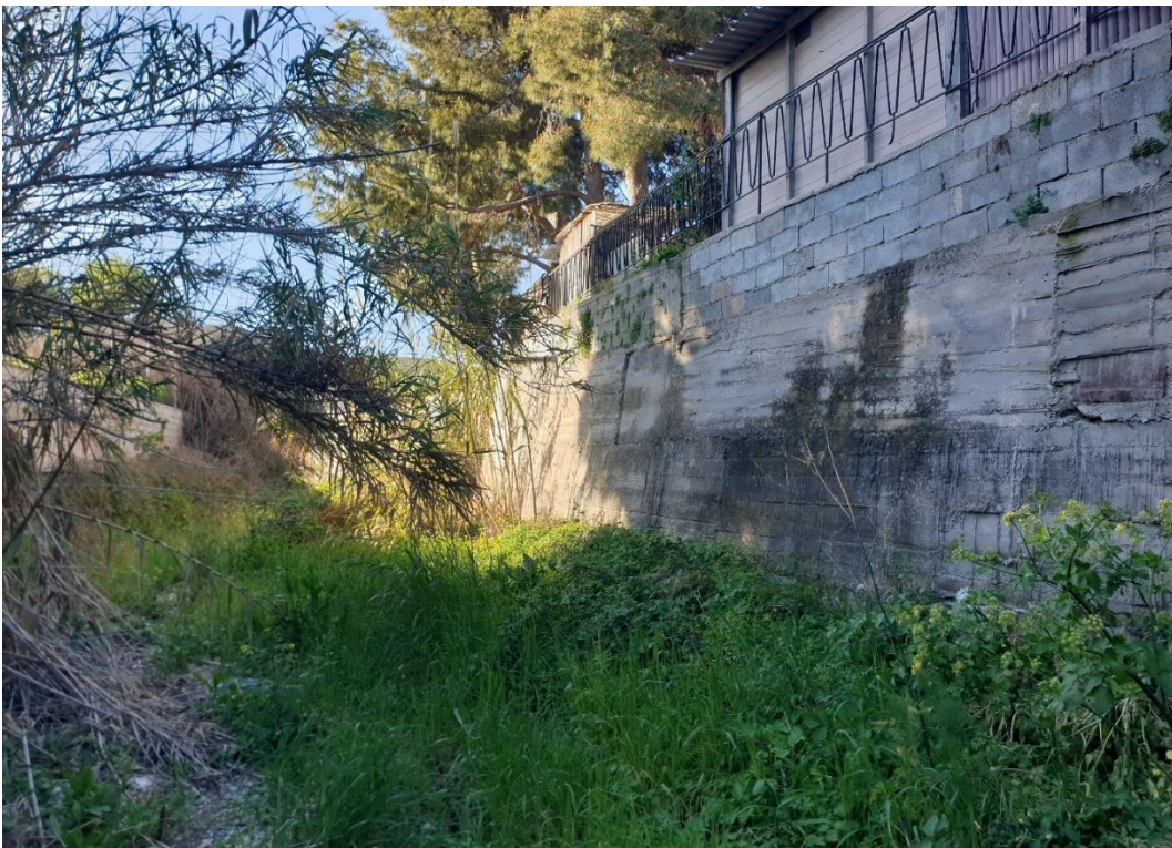
Φωτογραφία 3: Άποψη του ρέματος Κουβαρά περί της διατομής ΔKB-139. Διακρίνεται υφιστάμενο τοίχιο στην περιοχή της αριστερής όχθης (λήψη: Μάρτιος 2023, κατεύθυνση της λήψης: NA)
